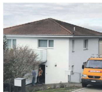
Tonziegeldach mit Schwarzalgenbefall.
