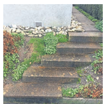
Treppe mit Flechtenbefall.
