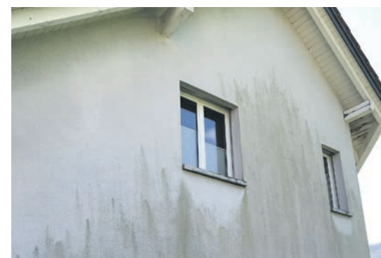
Putzfassade mit Grünalgenbefall.
