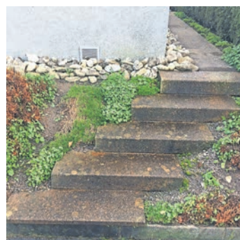
Treppe mit Flechtenbefall.
