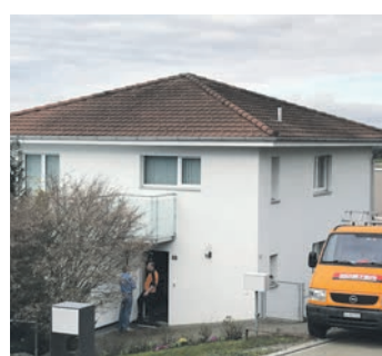
Tonziegeldach mit Schwarzalgenbefall.
