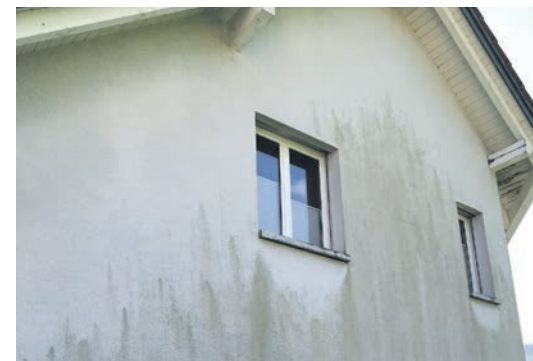
Putzfassade mit Grünalgenbefall.
